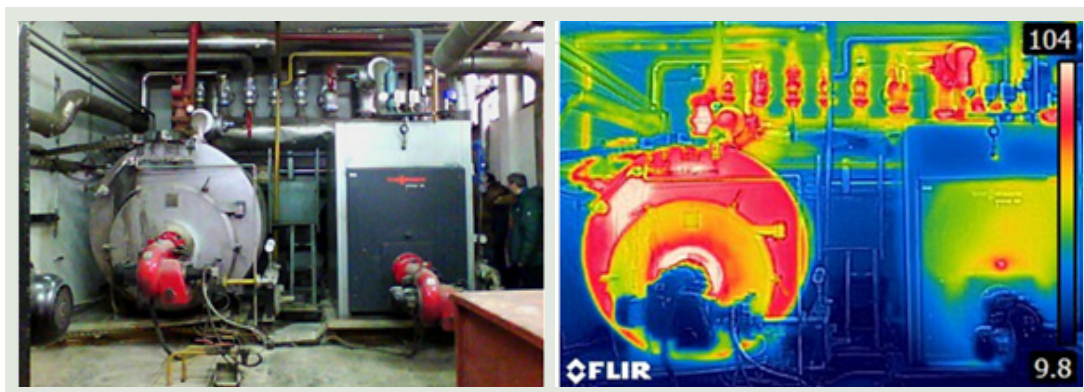
Slika 17. Gubici topline kroz oplatu kotlova, oštećena izolacija kotlova i parovoda (arhiva autora)
