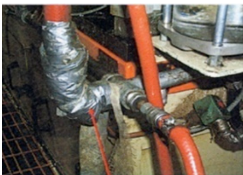
Slika 10. Oštećenost distributivne mreže komprimiranog zraka (pojava curenja)
