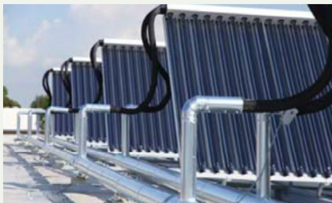
Slika 47. Solarni kolektori na krovu kompanije [79]
