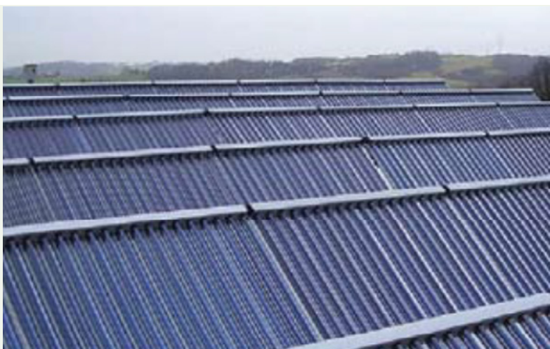
Slika 45. Vakuumske cijevi kolektori na krovu kompanije [79]
